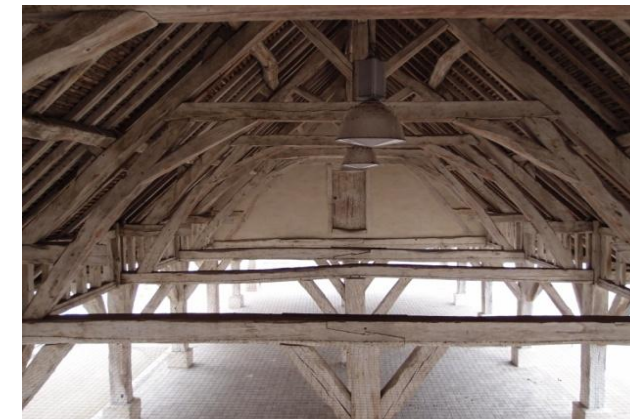
Charpente non favorable pour les chiroptères car des filets anti-pigeons ont été installés
