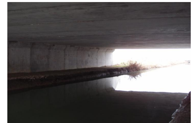
Pont de l'autoroute A19. Les joints de dilatation sont potentiellement favorables pour les chiroptères
